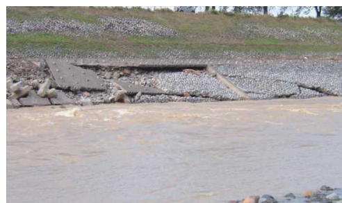
写真67: 庄川堤防護岸欠壊及び根固流出
