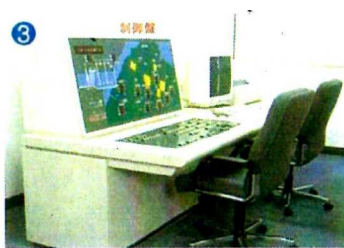
写真59： 揚水機場制御盤
