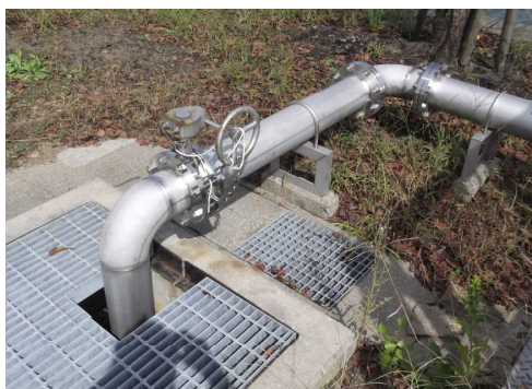
写真53：二の丸排水ポンプ水門施設 3
