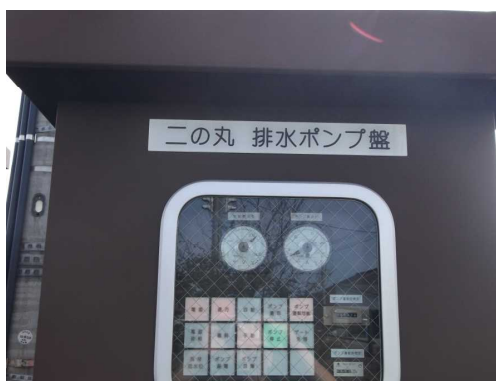
写真51：二の丸排水ポンプ水門施設 1
