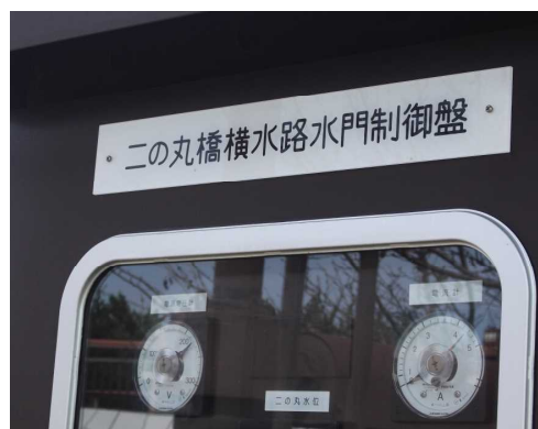
写真52：二の丸排水ポンプ水門施設 2
